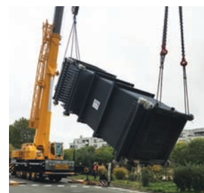
Module de convection de la chaudière biomasse du Fort de l'Est
